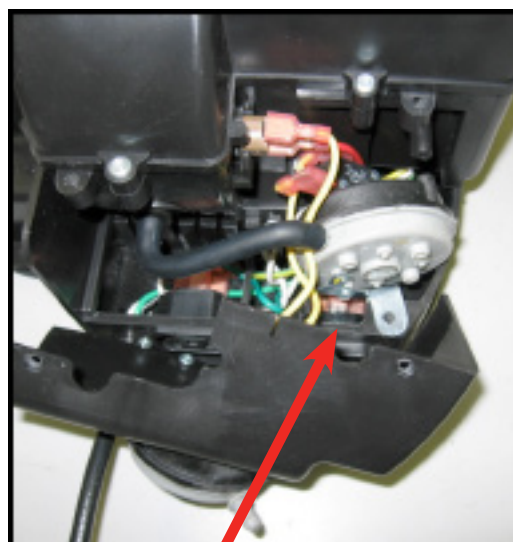
Interrupteur de pression négative de sortie des gaz
